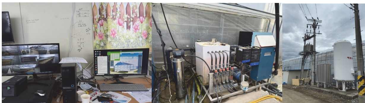
写真4 スマートファーム設備（左：管理端末、中：溶液装置、右：電気ヒートポンプ）
